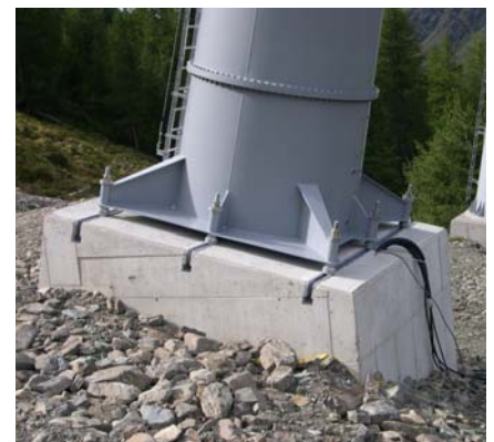
Querverschiebbarer Stützenfuss einer Sesselbahn
